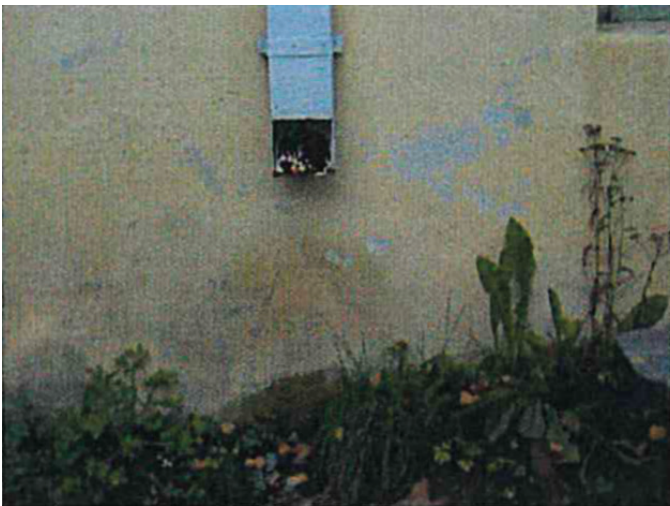
Kaakon puolisen julkisivun vesivaurioita
