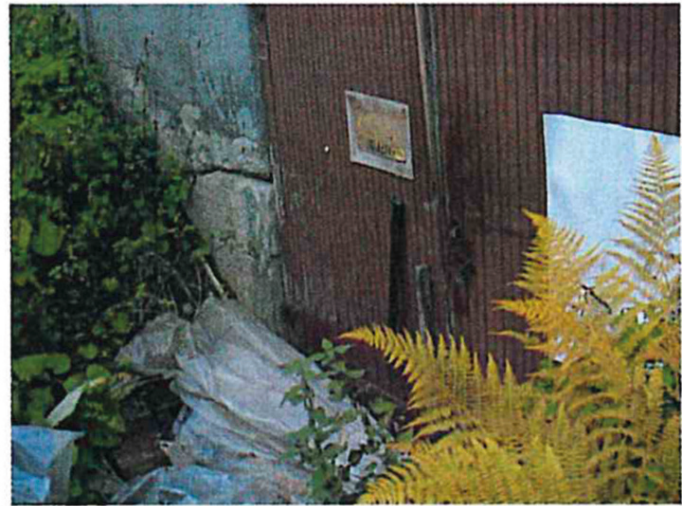
Sokkeli on tässä kohdin painunut sisään.
