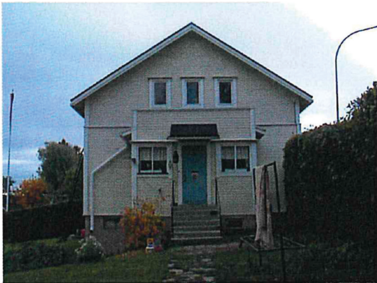
Luoteispäädyn portaat ovat kallellaan
