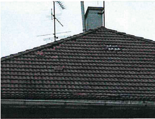
Länsipäädyn irronneita kattotiiliä
