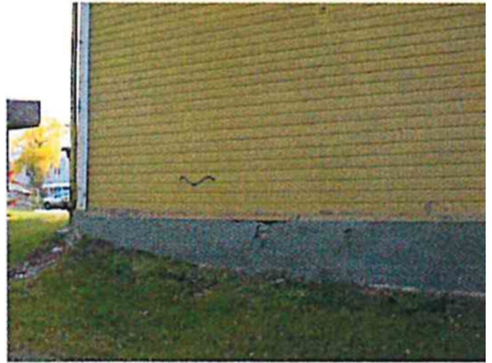
Luoteispäädyn sokkelissa laastikerros halkeillut
