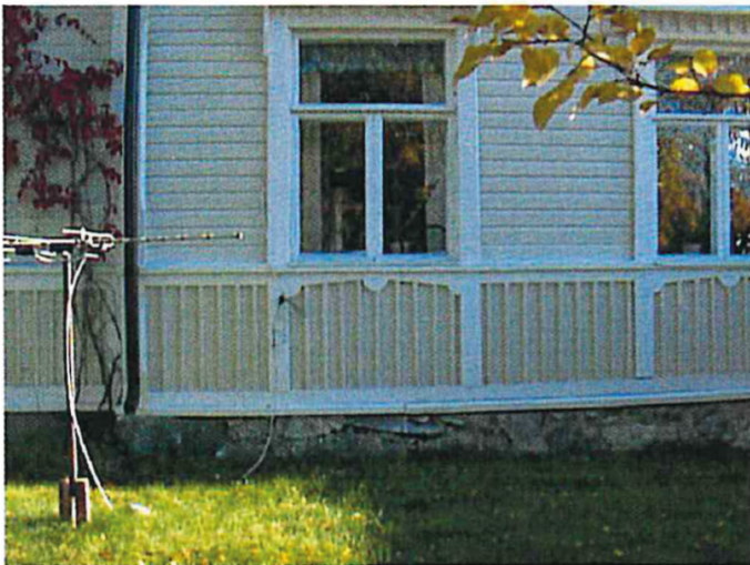
Kivijalan rappauksessa halkeama
