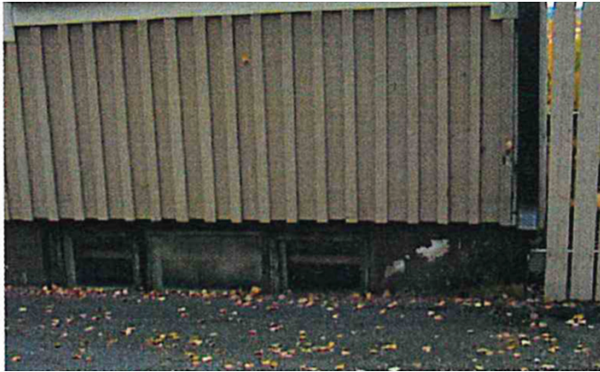
Kirkkokadun jalkakäytävän asfalttipinta on kellarin ikkunoiden alapintaa ylempänä. Sokkelissa maali on paikoin karissut.
