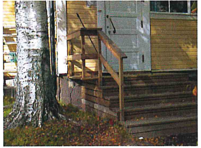
Kuistin sokkelin halkeama
