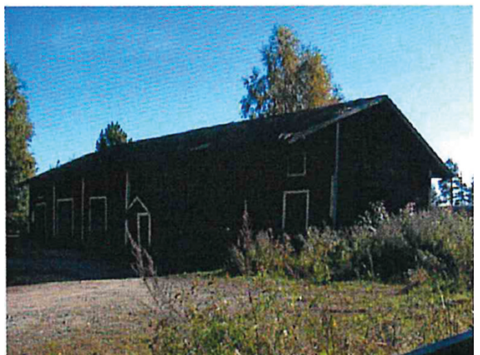
Länsinurkalla oleva maakasa on lahottanut alahirret ja rakennus on kallistunut Pieliselle päin.
