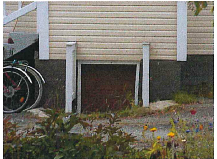
Kuistin sokkeli ei ole kohdallaan
