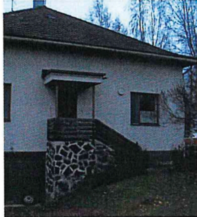
ja vaurioitunut porras
