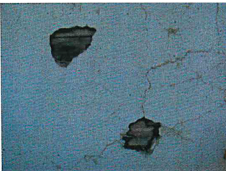
Piharakennuksen rappauksen alta paljastuu lautaseinä
