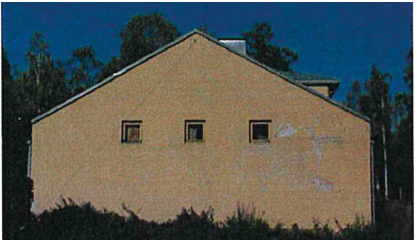
Kirkkokatu 28:n tiiliosan rappauksen halkeamia ja maalin hilseilyä.
