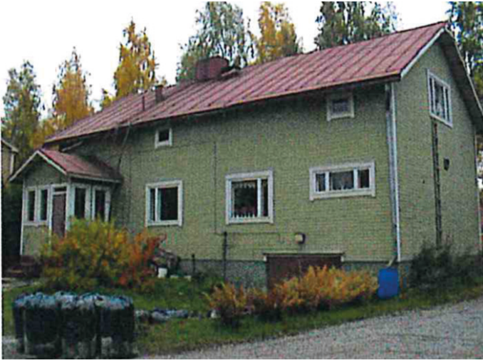
Sokkelissa on suuri halkeama autotallin oven vieressä.
