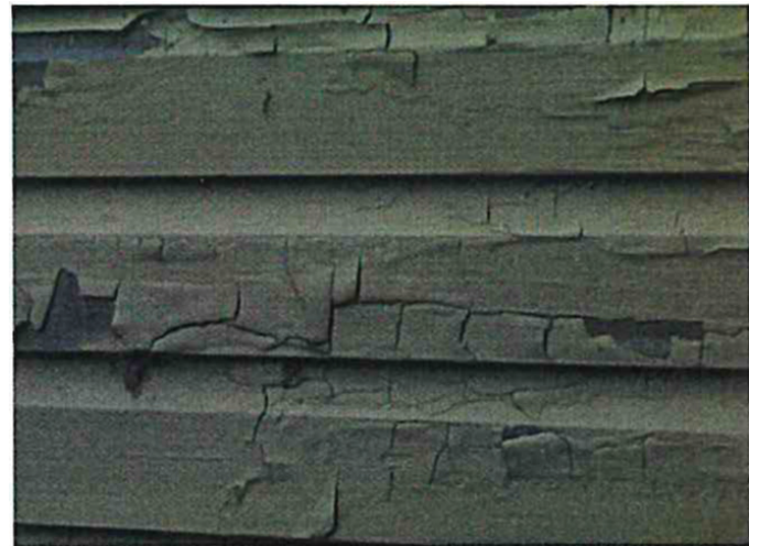
Tässäkin kohteessa julkisivulaudoitus on maalattu liian tiiviin pintakalvon muodostavalla maalilla. Rakennus tulisi tutkia myös sisältä korjaustöiden laajuuden selvittämiseksi.
