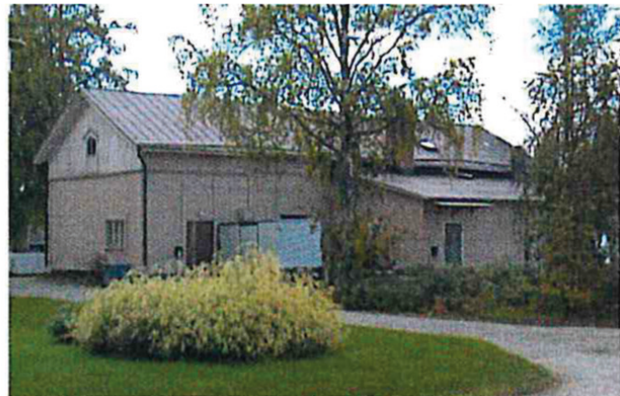
Rakennuksen koillispääty on vääntynyt
